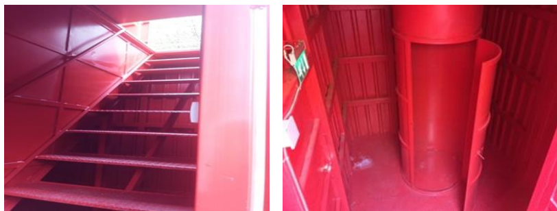
Figura nr. 4 – Modulul de simulare a subsolului unei clădiri civile și canalul tehnologic
